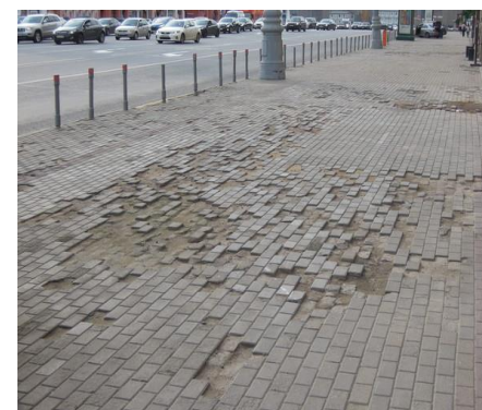
Рис. 1. Разрушенное тротуарное покрытие
