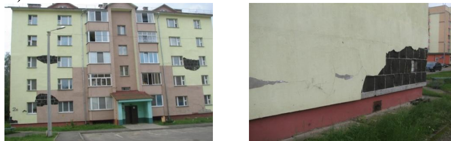
Рис. 1. Фрагменты фасадов здания с выявленными повреждениями
