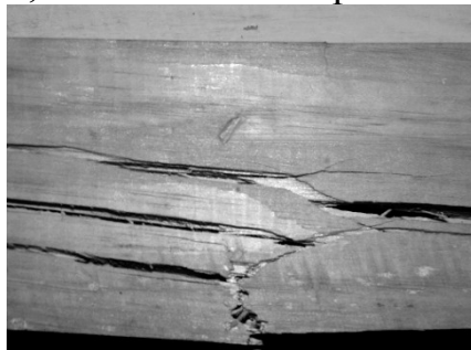
Рис. 1. Зона разрушения балки
