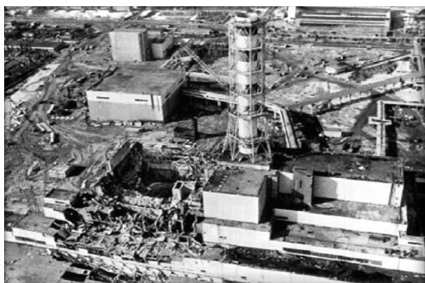
Рис. 6. Вид разрушенного 4-го блока ЧАЭС [9]
