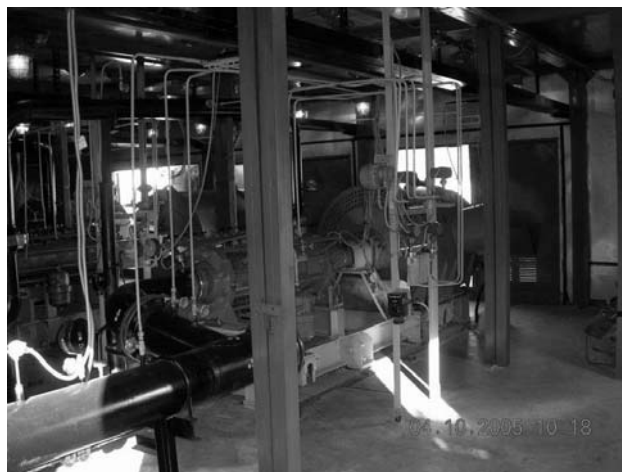
Рис. 4. Насосные агрегаты ГДМ8-03-125/750-400 в НПУ «РИТЭК Белярскнефть»
